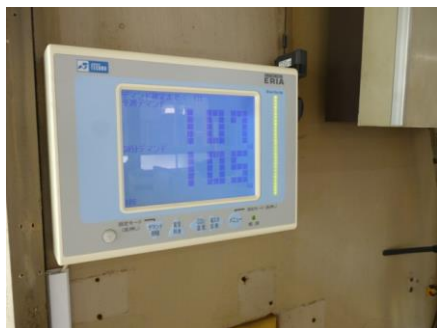
デマンド制御パネル (2010年7月設置)
