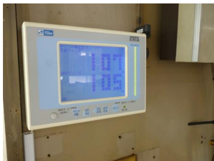
デマンド制御パネル (2010年7月設置)
