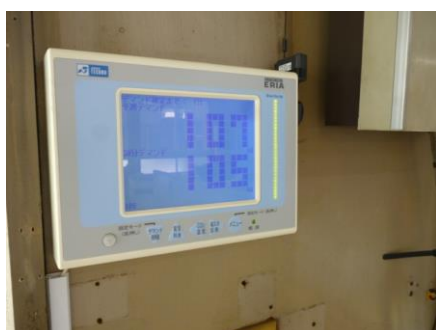
デマンド制御パネル (2010年7月設置)
