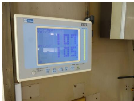
デマンド制御パネル (2010年7月設置)
